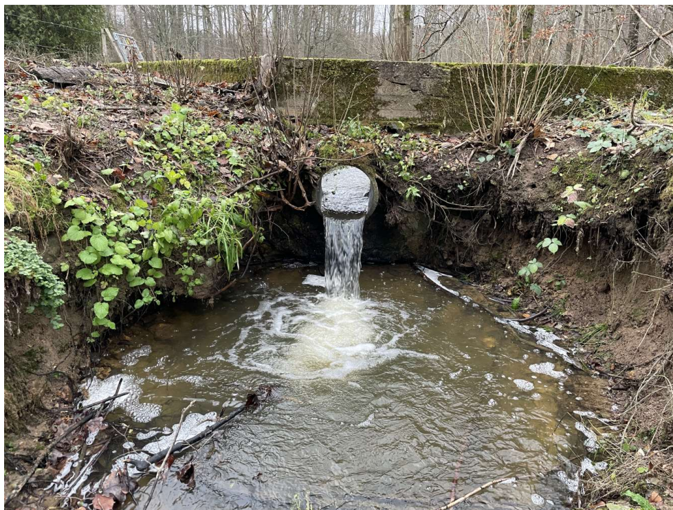
Figur 15. Styrtet igennem et 50 cm rør i en betonmur i den vestlige skovbæk øst for ejendommen Hesbjerg Skovvej 101 set i december 2023.
