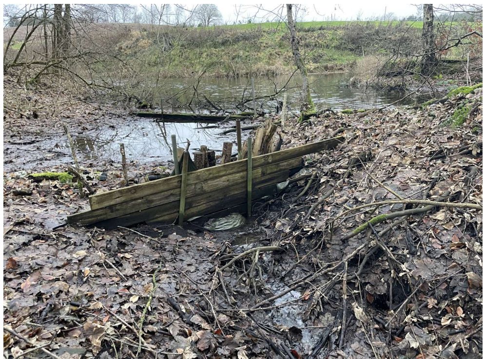
Figur 18. Stemmeværket i udløbet af den nordlige sø ved Grynborg set i december 2023. Vandet forsvinder i et hul i jorden i forgrunden af billedet.
