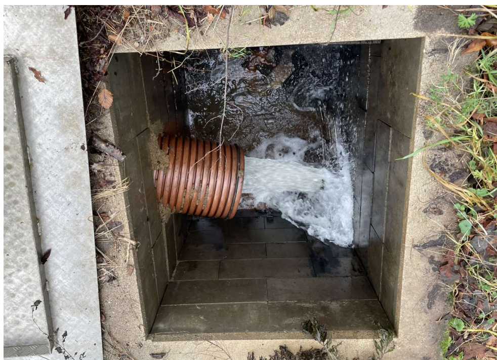
Figur 14. Styrtet i brønden vest for Hesbjerg Skovvej set lodret ned i december 2023.
