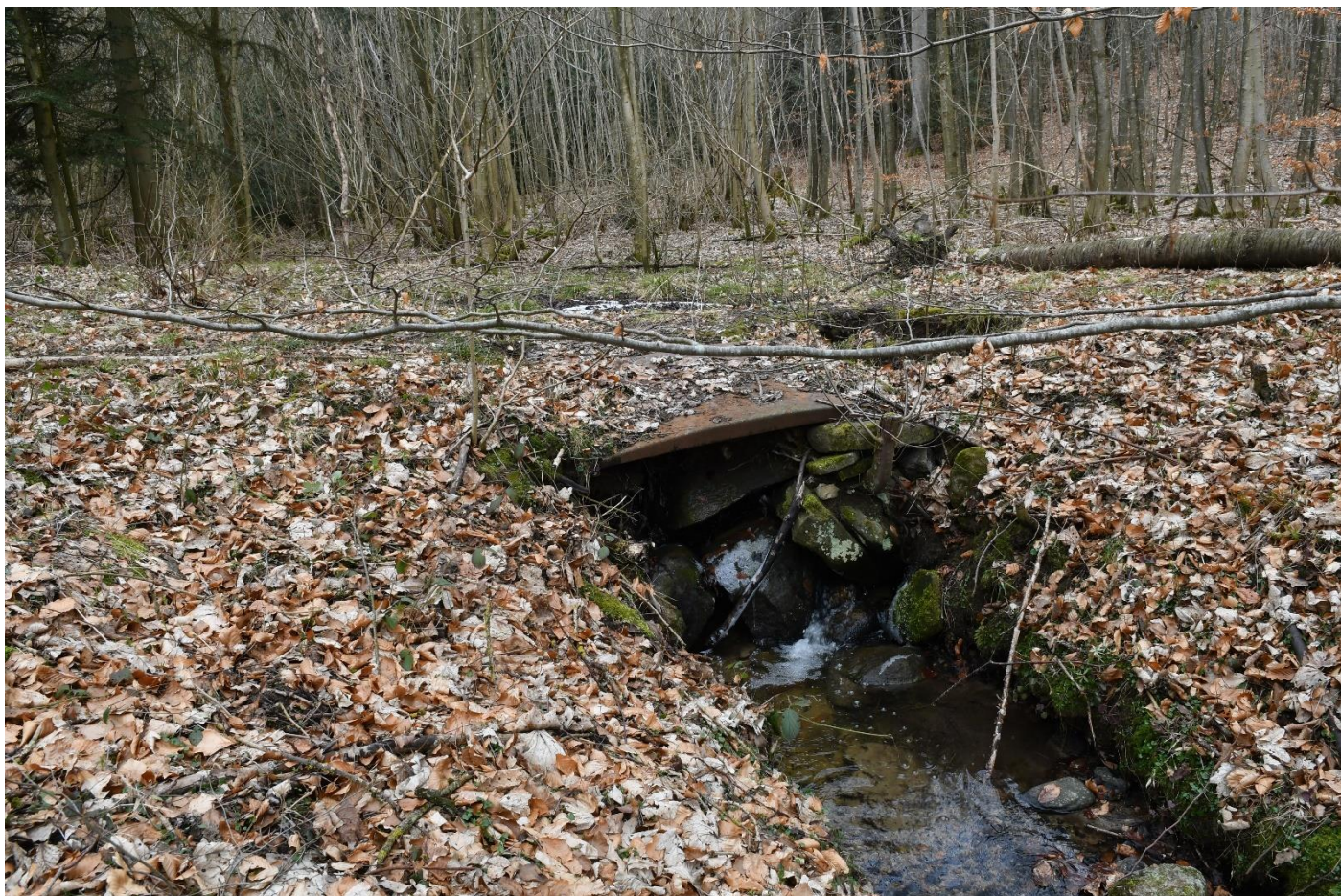
Figur 7-15. Den næsten sammenstyrtede rørlægning i den allervestligste del af afd. 31 mod afd. 4.
